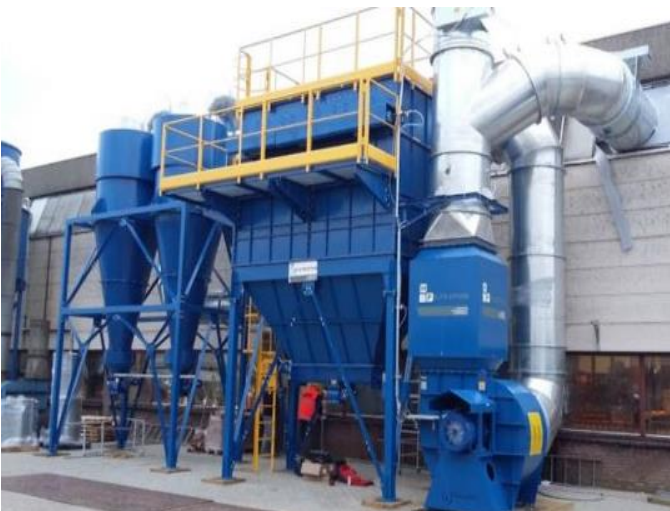
Impianti filtraggio fumi su misura
